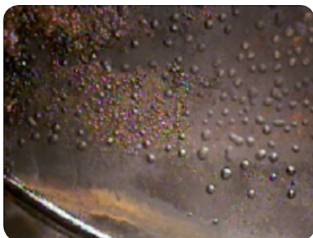
Phénomène d'hydrogène blistering sur la paroi d'un réservoir. Source : www.maverickinspection.com (D.R.)
